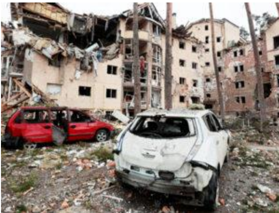
Κατεστραμμένα από το σφυροκόπημα του Ρωσικού στρατού διαμερίσματα στην πόλη Ιρπίν, κοντά στην πρωτεύουσα της Ουκρανίας. Συναντώντας διάχυτη πάλη κατά της εισβολής τους οι κυρίαρχοι της Ρωσίας στοχεύουν αστικές περιοχές, σκοτώνοντας άμαχους πολίτες. REUTERS/SERHII NUZHNNENKO
